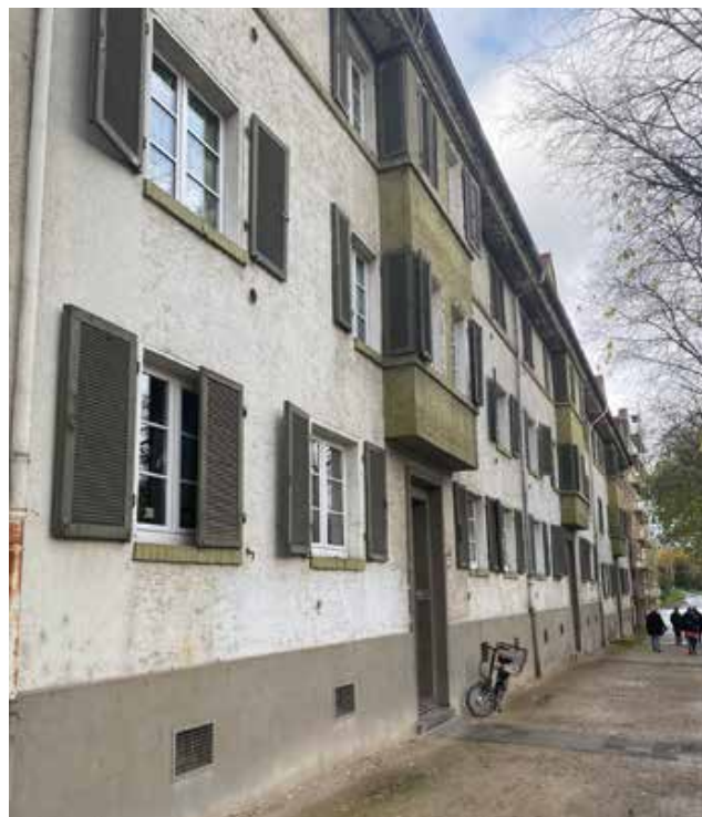
Abbildung 8: Sanierungsbedarf in der Güterhallenstraße
